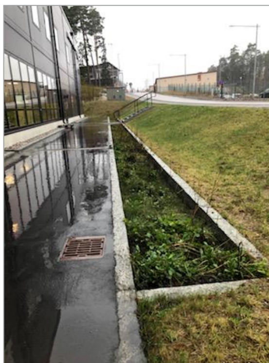
Figur 4:4. Takdagvatten avleds till regnbädd (foto: Norconsult).
